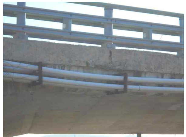
S3 외측 파손(0.2m×0.5m)
