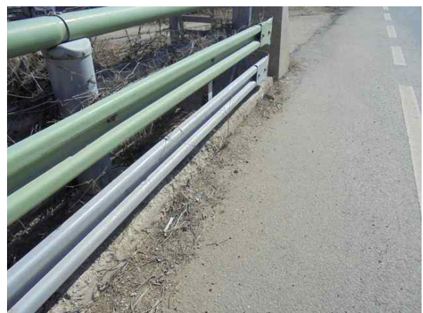
S1 접속부 연석 파손 (0.8m×0.3m)
