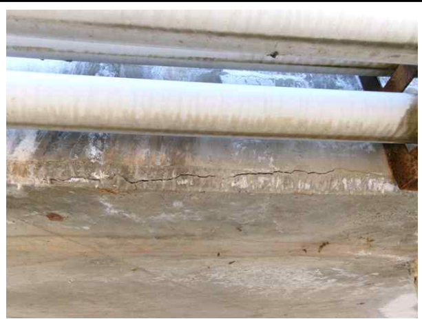
S3 파손 (4.0m×0.3m)
