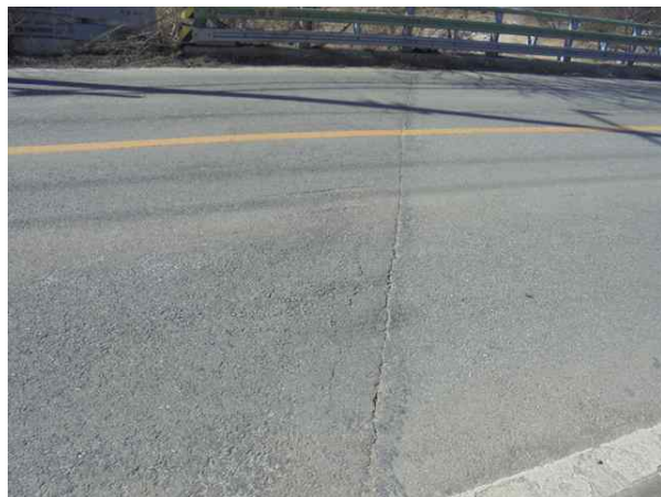
S1 접속부 균열 (3.0m)
